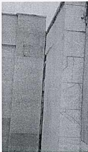
شکل ۱۷- عدم پوشش مناسب درز انقطاع و چسبیدن آن به ساختمان مجاور بوسیله مصالح سنگی نما و پرکردن این فاصله با خرده سفال
