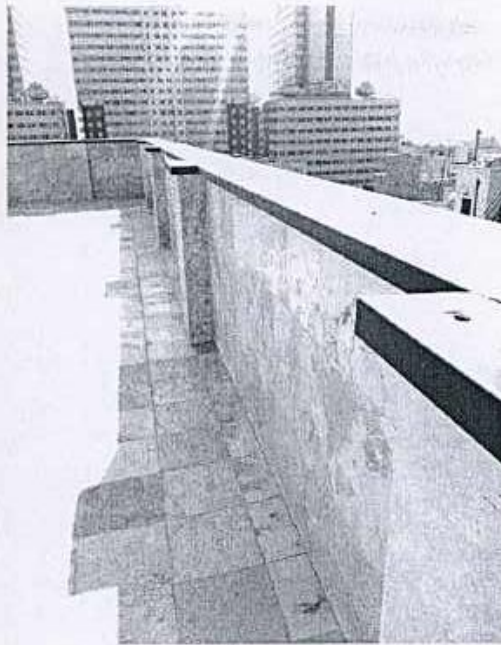
شکل ۲۰- کنترل مجدد ارتفاع جان پناه بام و درپوش آن
