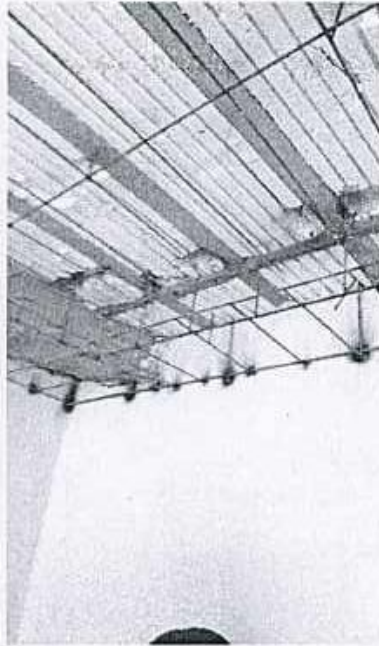
شکل ۳- ساپورت گیری نامناسب از تیرچه و تخریب آنها
